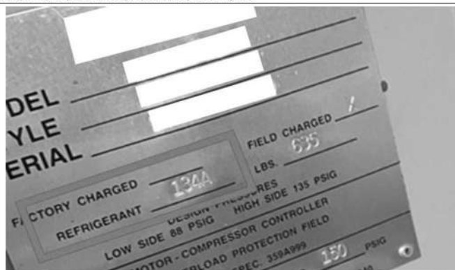
圖 2-9、冰水主機主機銘牌範例
