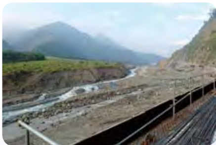
▲桃源區荖濃溪砂石清除及改變水道避免水流沖擊橋墩情形(改善後)(2016.11.18)
