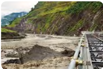
▲桃源區荖濃溪砂石及水流沖擊橋墩情形(改善前)(2016.6.13)
